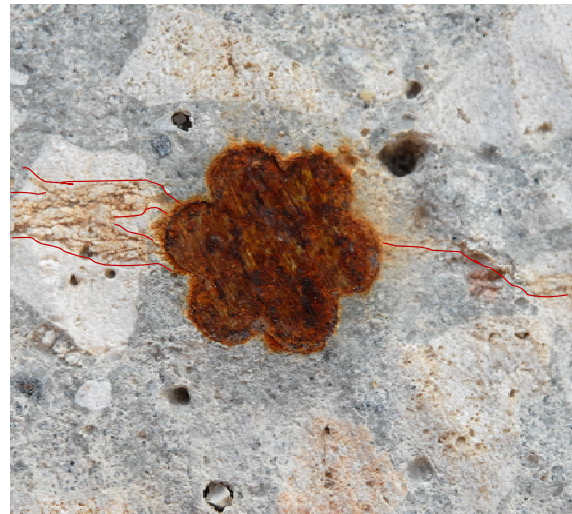
(D) Fine Inter-Strand Cracking
